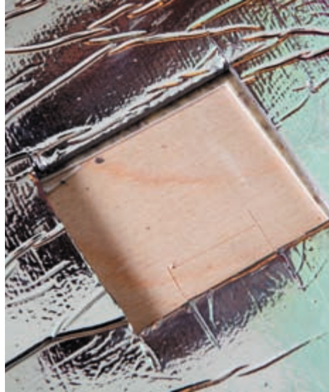
Рис. 23. Отверстие под датчик температуры пола в теплоотражающем материале
